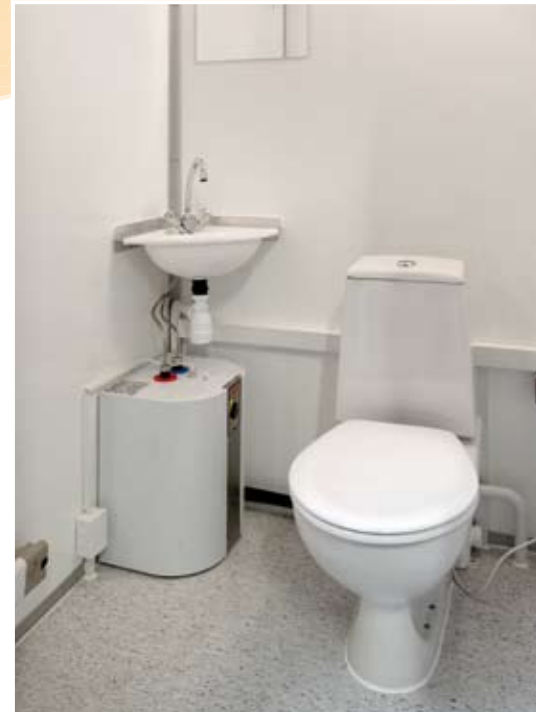
Velindrettet toiletrum med varme og vand-varme.
