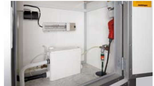
Et velordnet og overskueligt teknikrum med nem adgang fra vognens yderside.
